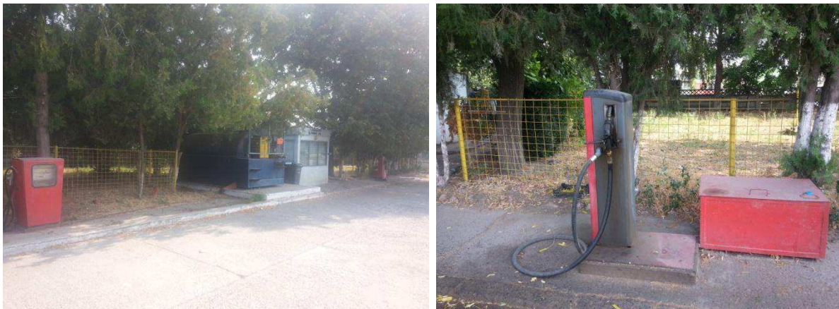
Figura 2.7.4 Stație alimentare carburant aflată în administrarea Serviciului de Transport Public al Municipiului Tulcea
